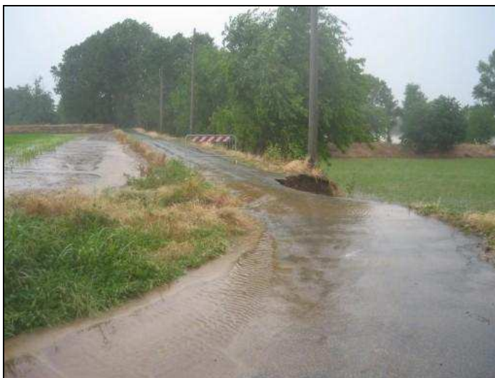
FIGURA 1-3 EVENTO DEL 15 - 16 GIUGNO 2010 DISSESTO SUL RILEVATO STRADALE DI VIA VILLETTA A CREMONA
