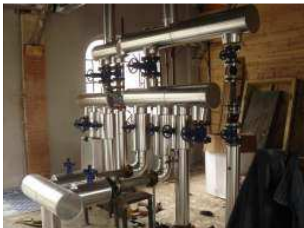
Gli impianti della centrale termica
