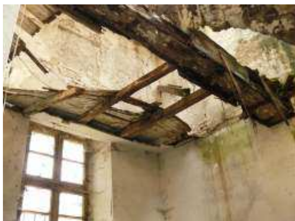
Crollo dei controsoffitti
