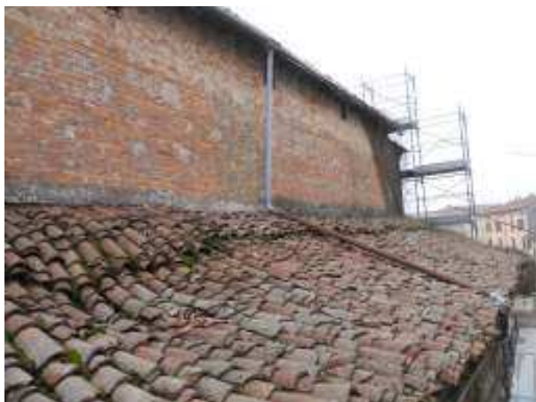
Stato di degrado della copertura
