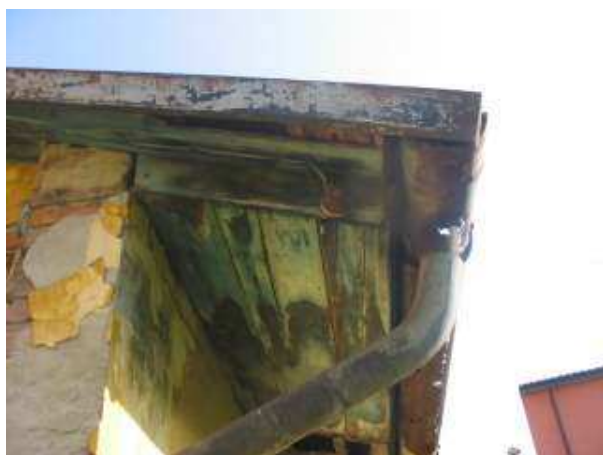
Lo stato della gronda...
