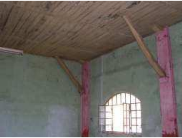
Il vecchio controsoffitto in completo degrado
