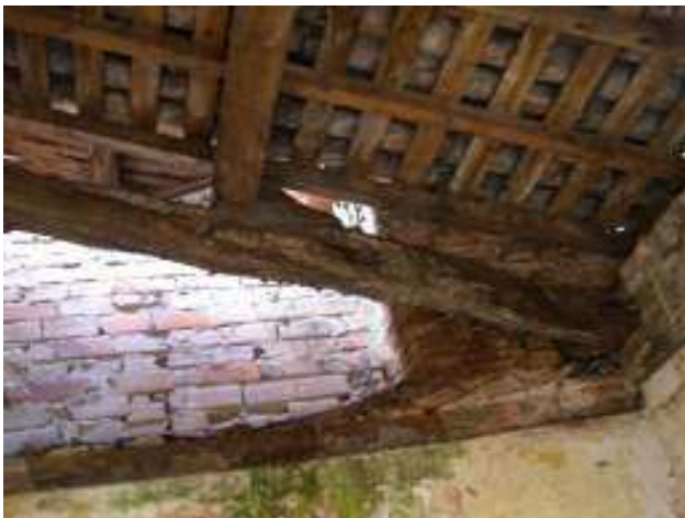
Stato di degrado dell'orditura interna
